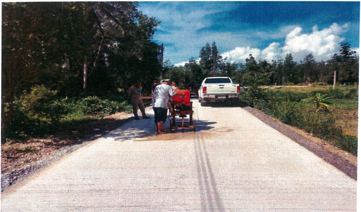
โครงการก่อสร้างถนนคอนกรีตเสริมเหล็กสายระหว่างคลอง - กุโบว์ หมู่ที่ ๘
